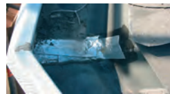
Flickstelle in der Dachrinne
