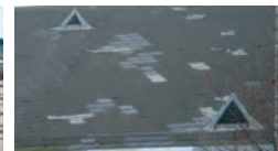
Flickstellen durch den Vandalismusschaden.
